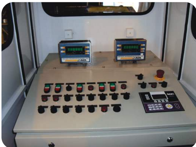
Painel de Comando
